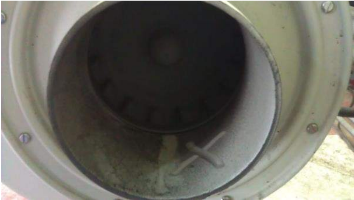
Room 3 – Extract Fan – Pre Clean
